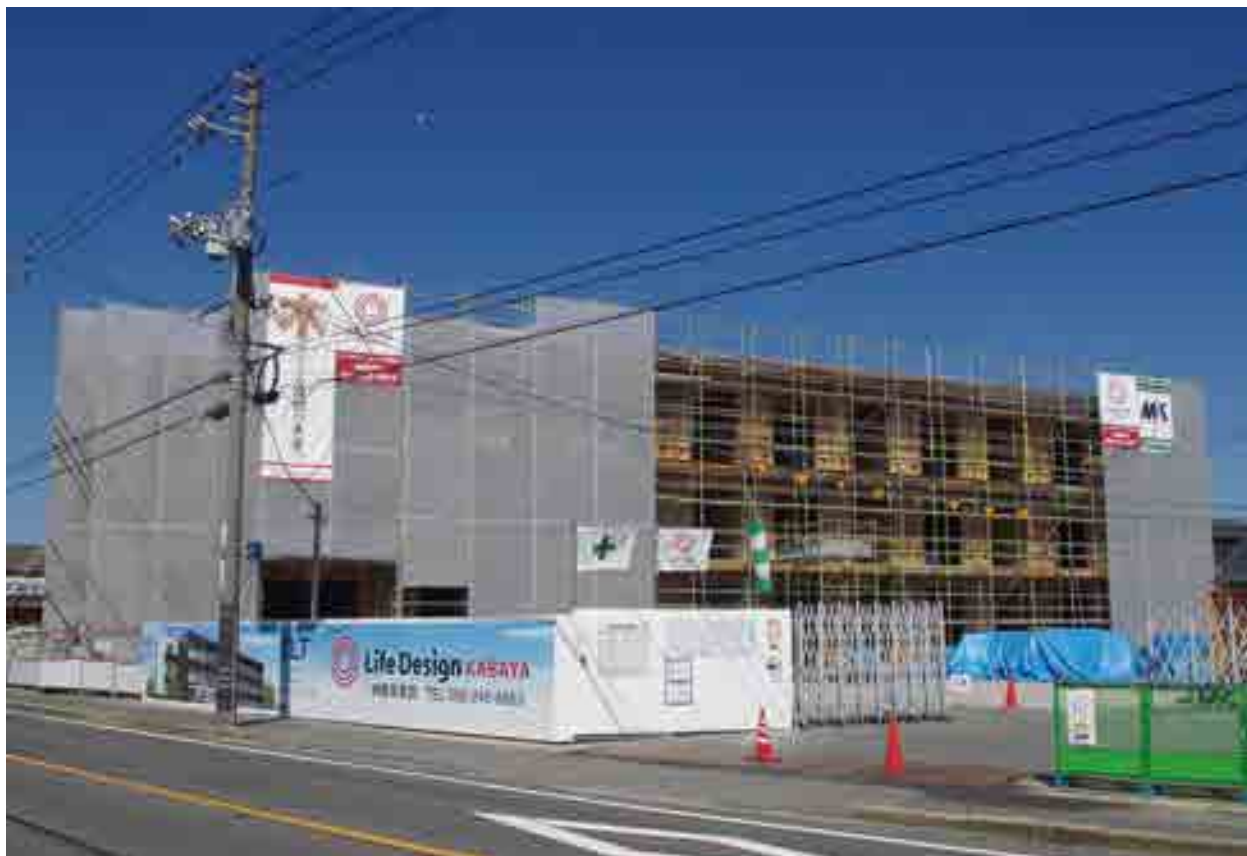
「オリジナルCLTコア構法」によって建設が進められているアイサワ工業(株)社員寮
